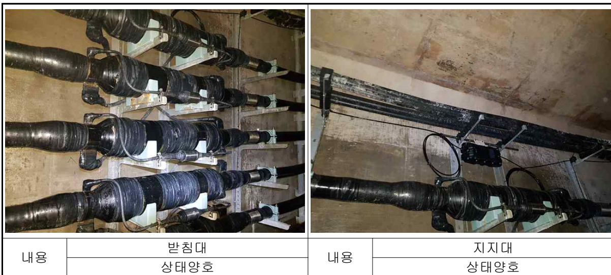
【사진 7.48】 부속 및 부대설비 현황
