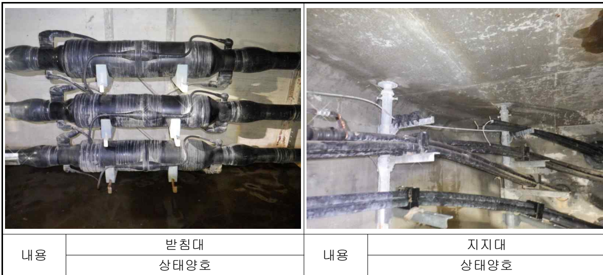
【사진 7.16】 부속 및 부대설비 현황
