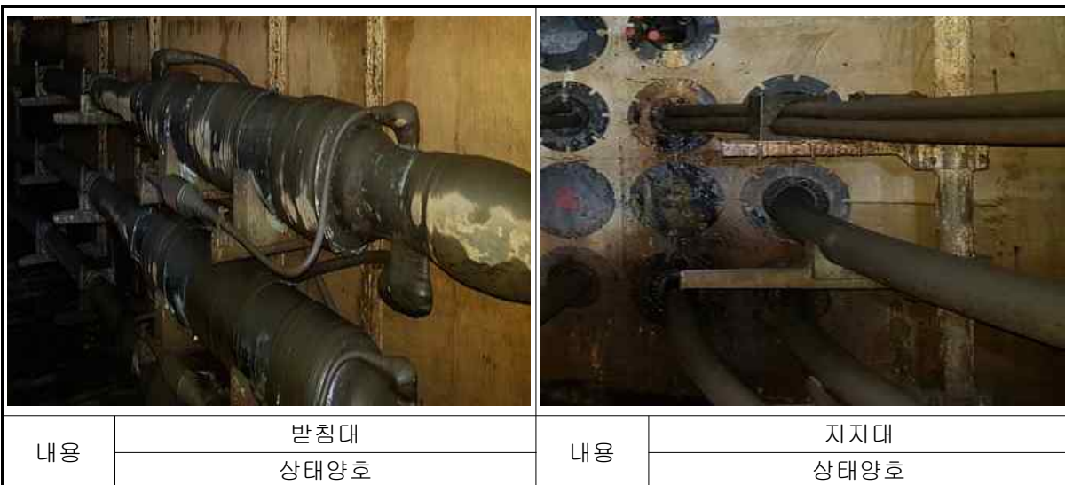
【사진 7.72】 부속 및 부대설비 현황
