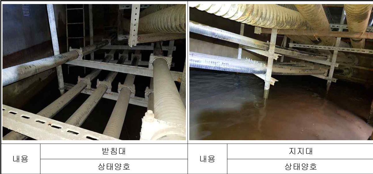
【사진 7.32】 부속 및 부대설비 현황
