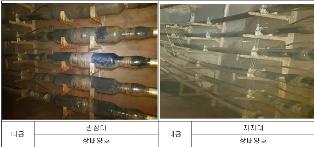
【사진 7.44】 부속 및 부대설비 현황
